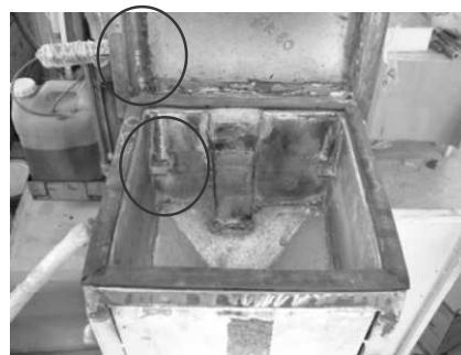
Figura 3. Recipiente de cloruro de metileno, los círculos muestran las imperfecciones que ocasionan fugas
