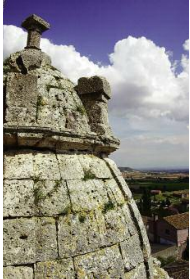
Fig. 11.- Remate del husillo de Guzmán, con cúpula de doble esfera festoneada con pináculos muy deteriorados.
