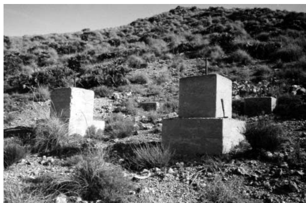
Figura 4. Bases de cemento sobre las que se anclaban las torres metálicas que sustentaban el cable aéreo.
