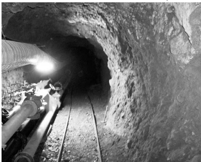
Figura 11. Aspecto del tramo medio de una galería de agua moderna con las instalaciones de ventilación, iluminación railes y conducciones. (Fuente: Santamarta, J., 2005).
