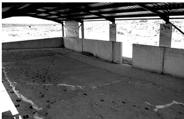
Figura 8. Vista del interior de la nave con las huellas resaltadas con productos especiales.
