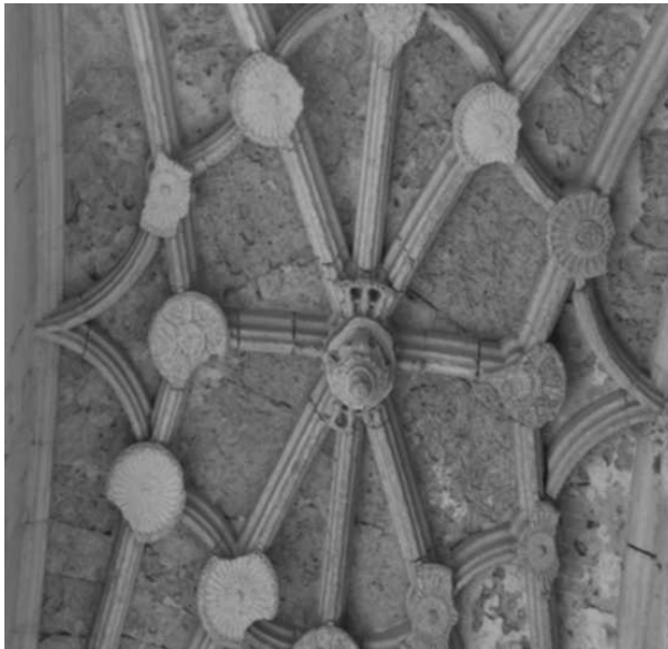
Fig. 3.- Bóveda de crucería estrellada del pórtico con varias claves (muy deterioradas).
