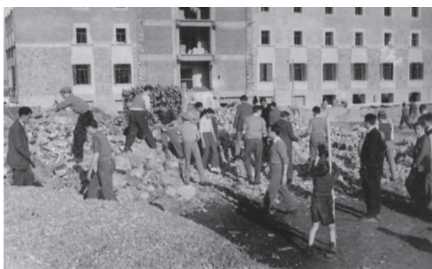
Fotografía. A.H.D.CC. Fondo Acción Católica. Durante una temporada los jóvenes trabajaban en el Seminario en Construcción los sábados por la tarde. 1953
