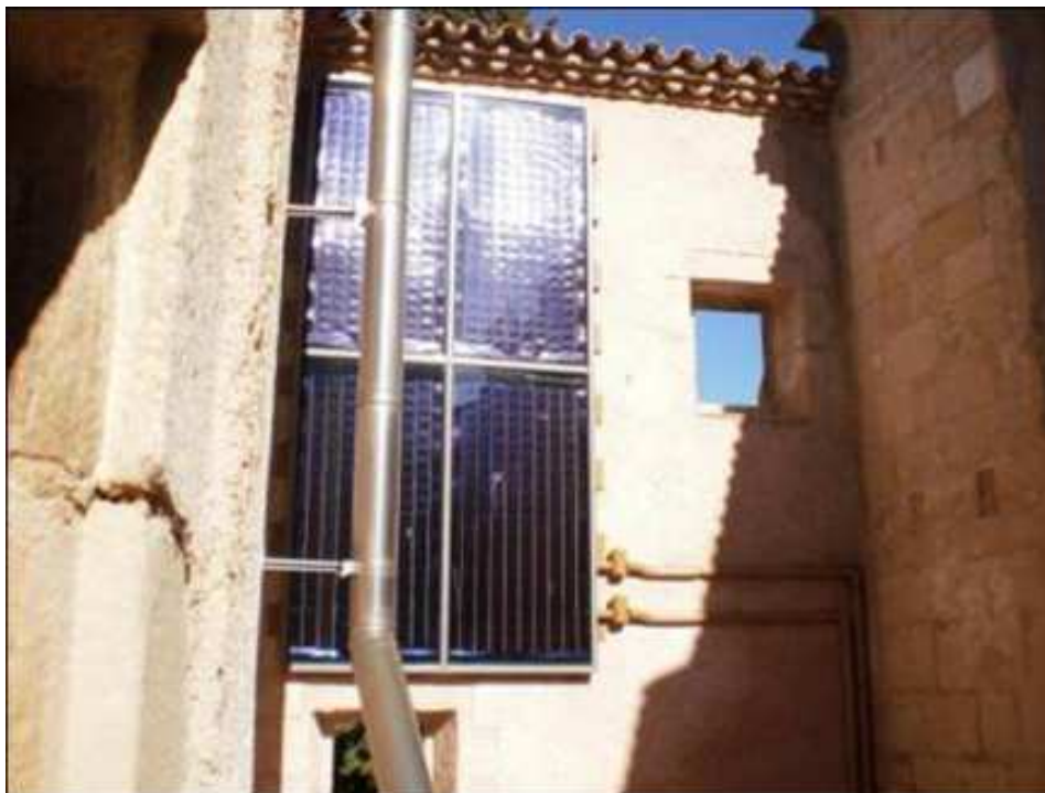
Captador solar tèrmic instal·lat a la Casa dels Germans de Poblet.
