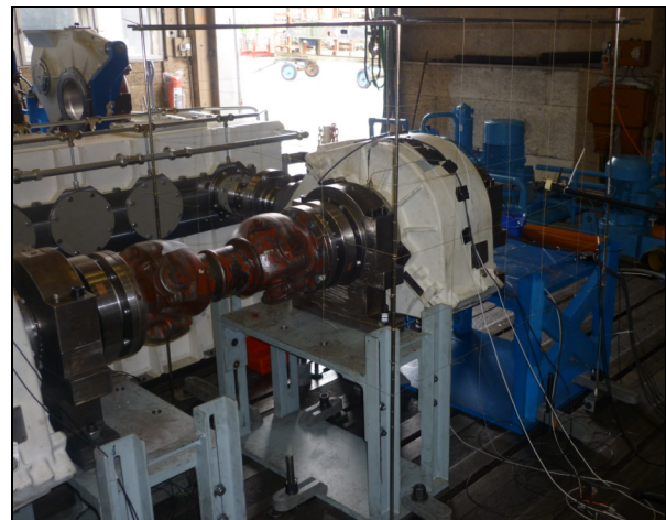
Figura 4. Situación de la superficie de medida en la reductora.
