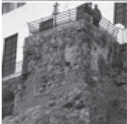
Torre del Adarve (Cenador nº 1). Antes y después de la consolidación de urgencia (recalce).
