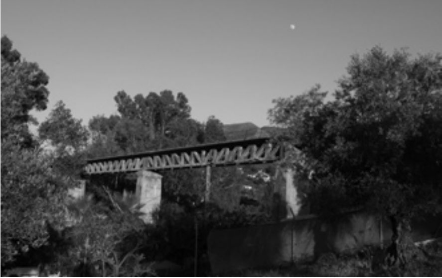
24. Viaducto sobre el río Fahala. Vigas en celosía. Fotografía: Guillermo Ordóñez Ordóñez.
