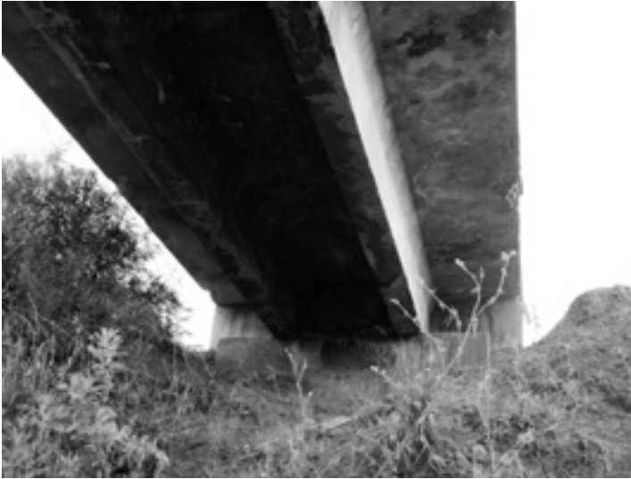
21. Viaducto sobre el río Fahala. Vista inferior de las vigas de sección en TT. Fotografía: Guillermo Ordóñez.
