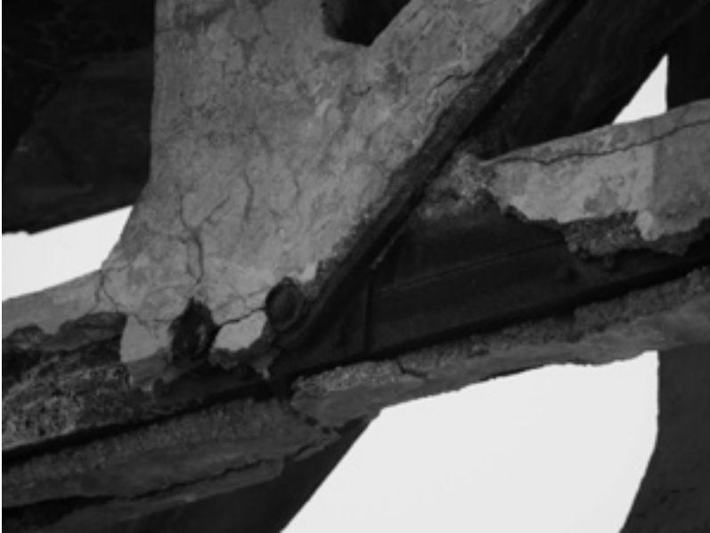
28. Viaducto sobre el río Fahala. Fisuración del hormigón en una viga en celosía. Fotografía: Guillermo Ordóñez Ordóñez.
