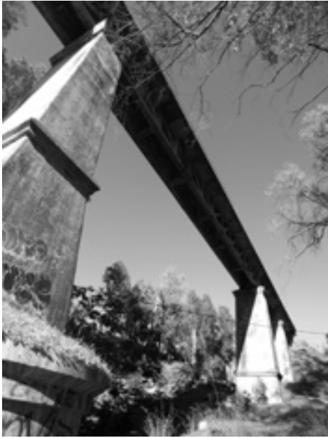
30. Viaducto sobre el río Fahala. Juego de volúmenes entre pilas y tramos rectos. Fotografía: Guillermo Ordóñez Ordóñez.
