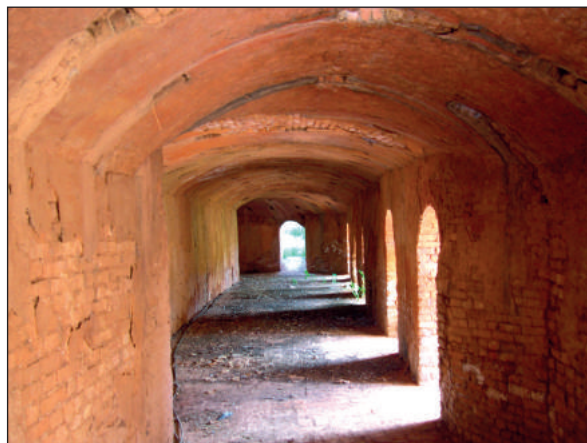
Fig. 10. Interior de la galería lateral del horno principal de cerámica, con accesos laterales (a la derecha de la imagen) y cámara del horno cerrada (a la izquierda de la imagen).
