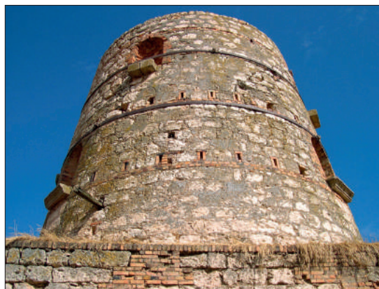
Fig. 13. Chimenea del horno de cemento principal.
