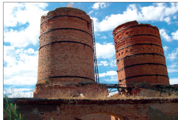
Fig. 16. Chimeneas del horno auxiliar de cemento, innecesariamente demolidas.
