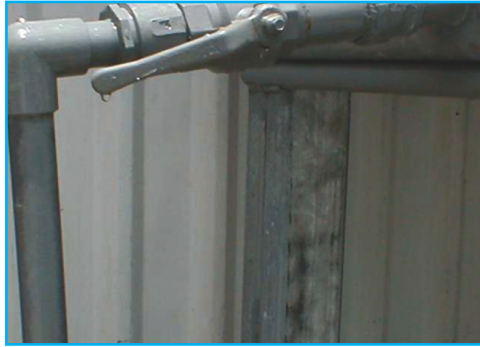
Pérdidas de agua que pueden ser evitadas a un bajo costo
