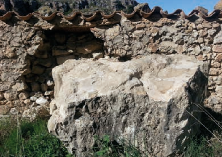
Fig. 2: Desprendimientos de rocas en Moneva (comarca de Campo de Belchite), tras las fuertes lluvias de octubre de 2012.
