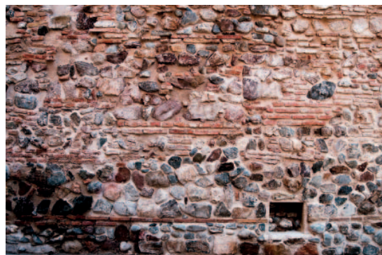
Foto 9. Detalle del aspecto de los forros de mampostería ladrillo en el tramo del número 30 tras la intervención, en la que se han consolidado estas estructuras y se ha realizado una limpieza y un nuevo llagueado. La ventana que aparece abajo a la derecha es un testigo a través del cual se aprecia un forro de mampostería interior, lo que indica la sucesión de reparaciones en este tramo
