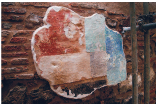
Foto 8. Detalle del fragmento de revestimientos conservado en el tramo del número 30. Se ha realizado una estratigrafía de los colores a la cal que se aplicaron sucesivamente sobre el muro
