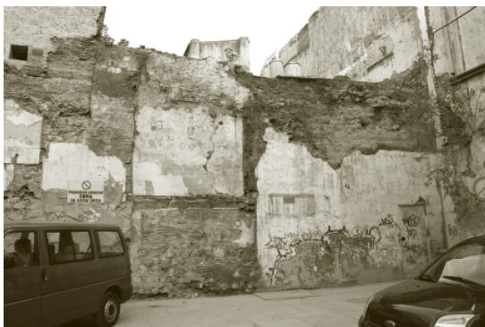
Foto 3. Vista del tramo derecho del fragmento, correspondiente a los números 32 y 34 de calle Carretería. En la zona superior derecha aparece una superficie en la que el enfoscado se ha desprendido, dejando a la vista el relleno seco que servía de base a la terraza del edificio. Bajo esa zona desprendida aparece una ventana horizontal que remata una puerta oculta y más a la derecha una puerta que estuvo en uso hasta la década de 1980
