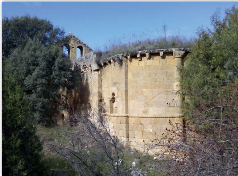
En el lado sureste, la vegetación hace más patente aún el avanzado estado de degradación y abandono.
