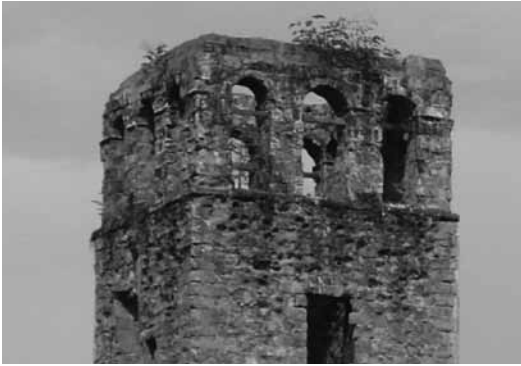
Figura 6. Vista del muro Sur de la torre donde se muestran las oquedades producto de la erosión. Foto: Félix Durán.
