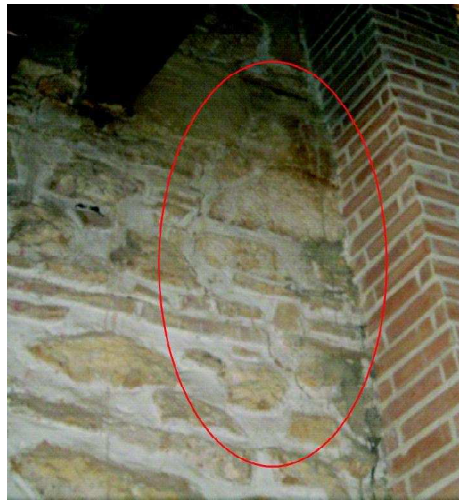
Fotografía 2. Detalle de muro de la iglesia Nuestro Señor de la Columna (Soracá)
