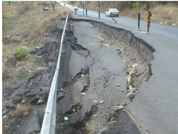
Deslizamiento típico de un relleno de carretera de montaña
