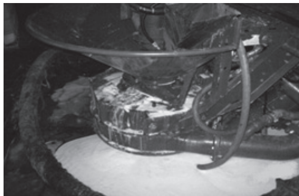
Figura 12. Derrame de aditivos en la unidad de mezclado
