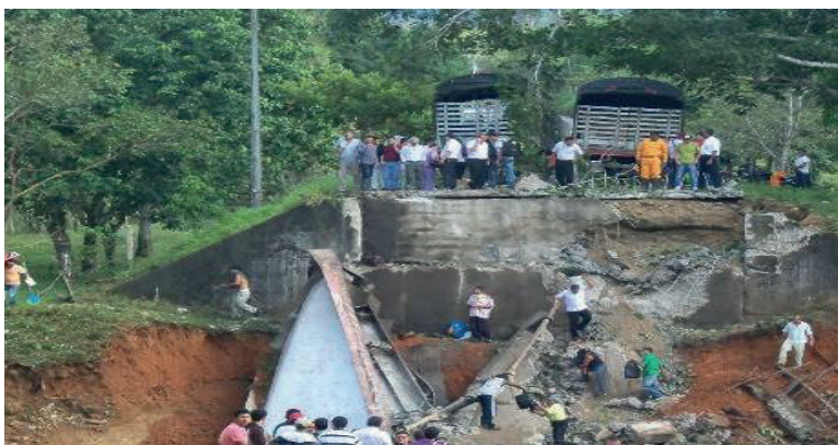
Figura 11. Panorámica del estribo sur del puente Riecito luego del colapso. Fuente: INVIAS, 2012 [11].
