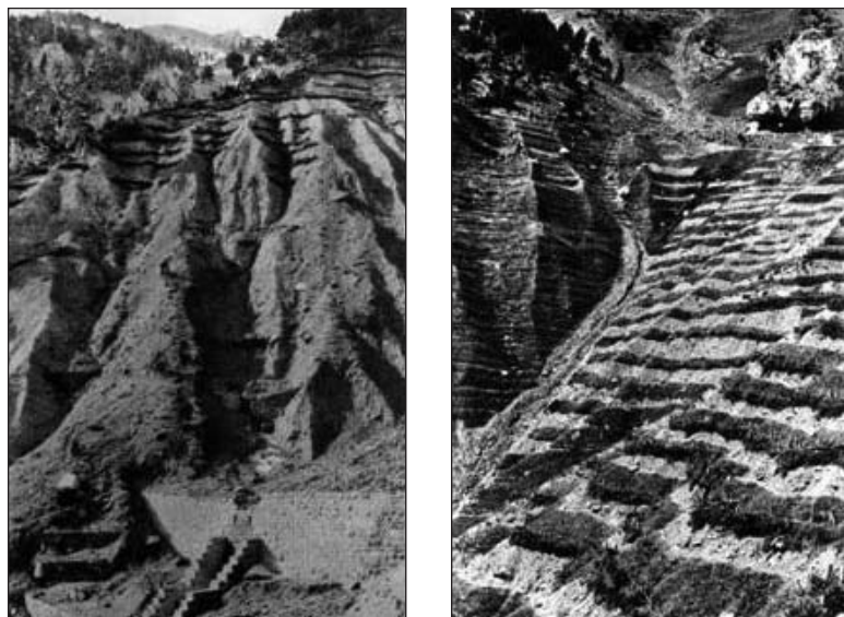
Fig. 20. Torrente de Los Meses. Dique final en construcción, con canalización y enfajinados para frenar la erosión (izquierda) y encespedamiento artificial por fajas (derecha). (Fotos: Benito Ayerbe)
