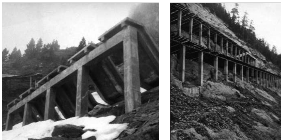
Fig. 29. Obras de José María Ayerbe para la defensa contra aludes en Estiviellas: rastrillo de placas de hormigón (izquierda) y puentes de nieve de madera (derecha). (Fotos: José María Ayerbe)
