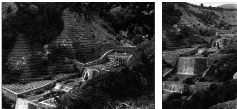
Fig. 14. Repoblación y obras de corrección del torrente de Arás. (Fotos: José María Ayerbe)
