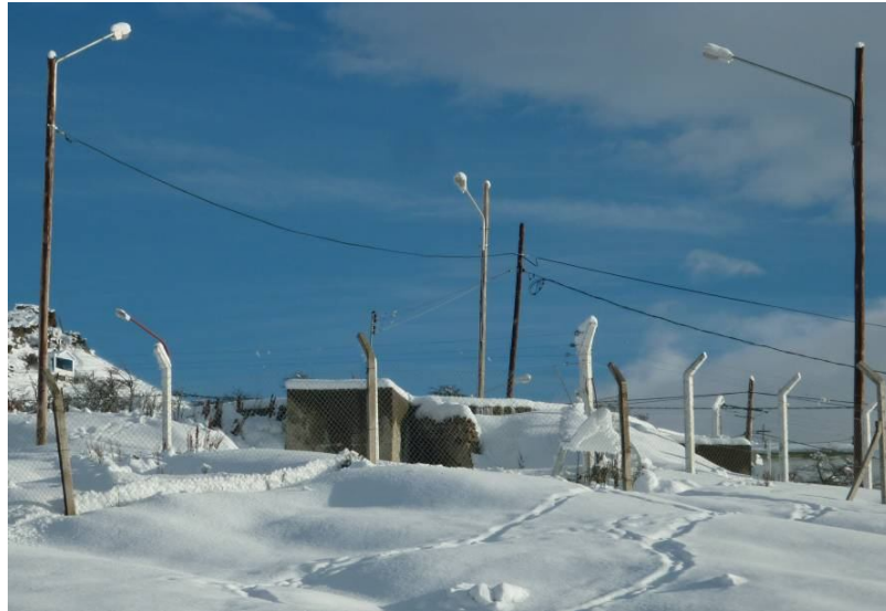
Figura N° 10. Tanque de abastecimiento de agua ubicado detrás de la UART-UNPA – Ex Hospital YCF. Fotografía: Ciancia D., Julio 2011.
