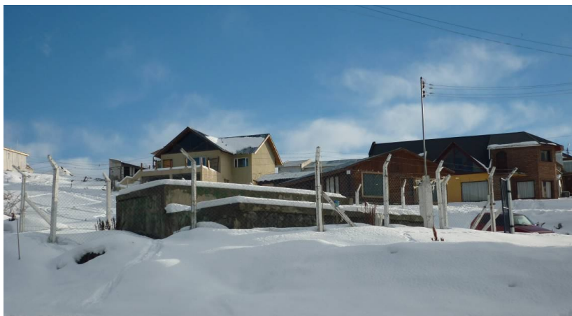
Figura N° 11. Tanque de abastecimiento de agua ubicado en el B° Los Ñires. Fotografía: Ciancia D., Julio 2011.
