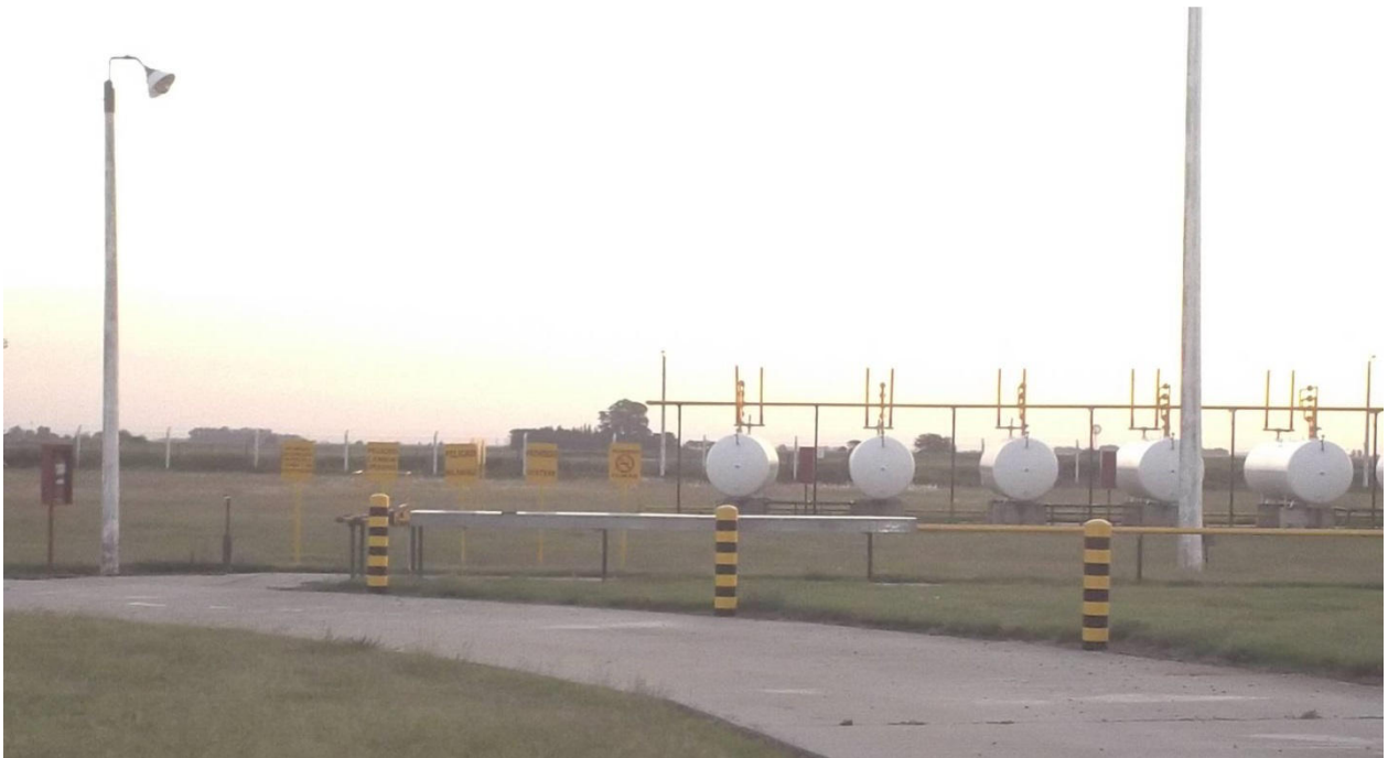
Foto N° 1 Planta de almacenamiento y vaporización del GLP en Roberts (2013)
