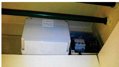
Módulos de control y medida (10 unidades)
