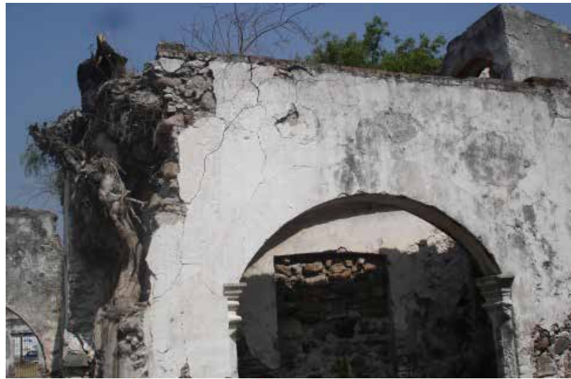
Figura 41. Vista del estado de deterioro en el que se encuentra la ex hacienda. © González.
