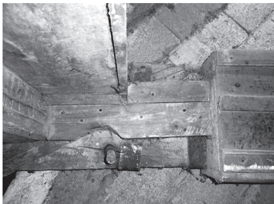
Figura 11. Pivote tipo barra: se observa el pivote en barra anclado a la pared, Aguadas, Caldas
