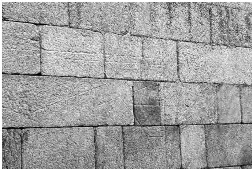
Marcas no exterior da fachada sur da Capela Maior
