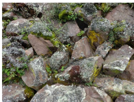
Figura 10. Muro de un andén deteriorado con especies herbáceas creciendo entre las uniones de las piedras (punto TB-30). Foto: K. Yakabi, marzo de 2013
