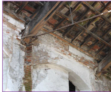
Fig VIII. Fotografía de union de la tiranta de hierro en muro de fabrica de ladrillo.
