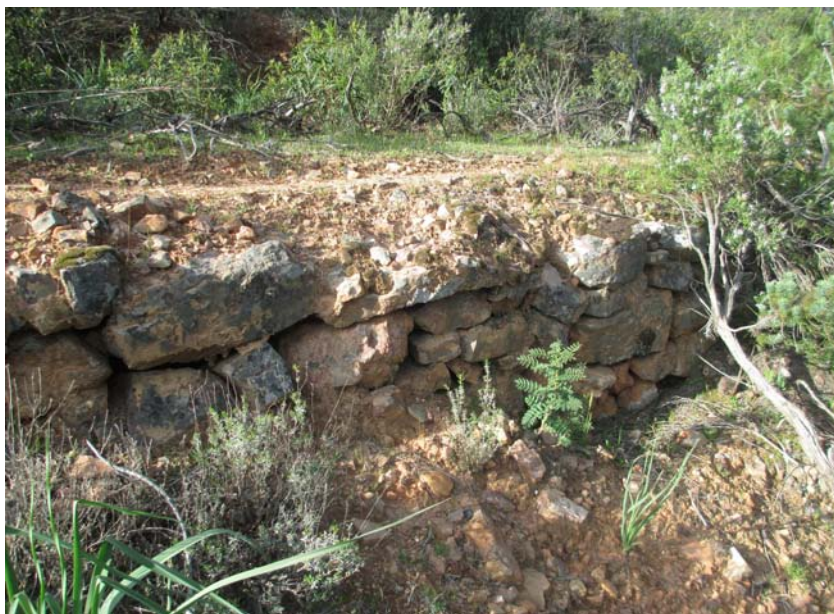
Muro de contención en el camino del Puerto del Rey, Término del Viso. Fotografía: M.Roll.
