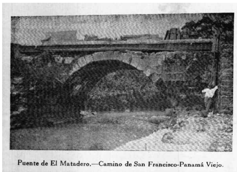
Figura 6. Imagen de los trabajos en el puente del Matadero. Fuente: Despacho de Agricultura y Obras Públicas (1932).
