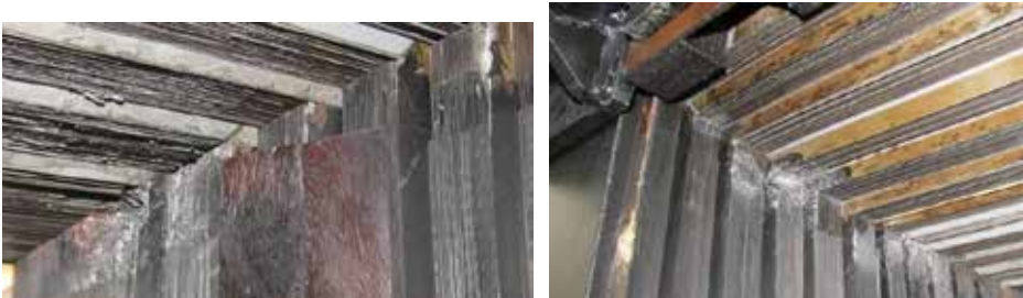
Figura 30. Cortos en el núcleo de unidad fallada.
