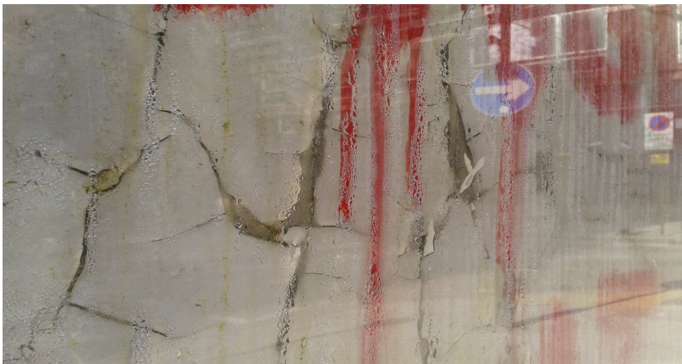
Figura 7. Detalle de las alteraciones sufridas en el mural –falta de transpiración, condensación, suciedad– a causa de la inadecuada colocación de la barrera física.
