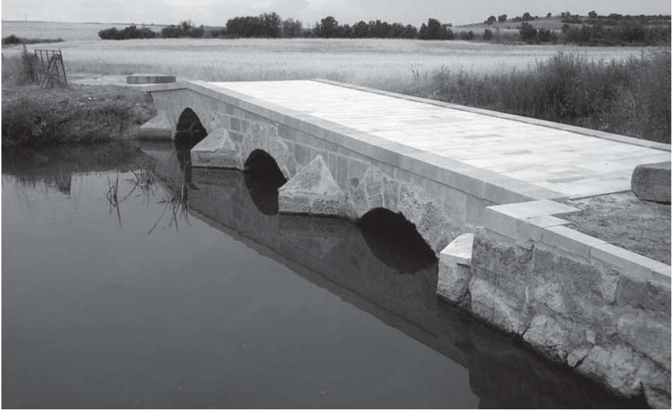
Fig 13. Estado final del puente aguas arriba. (STCZA 07-2013).
