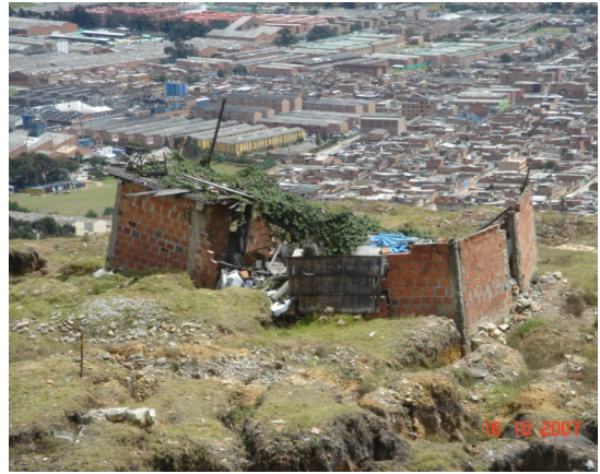
Foto 2 - Vista en campo de los efectos del deslizamiento sobre las viviendas. Ciudad Bolívar, Bogotá, Colombia. Fuente: Cuervo G. VARGAS, 2004.
