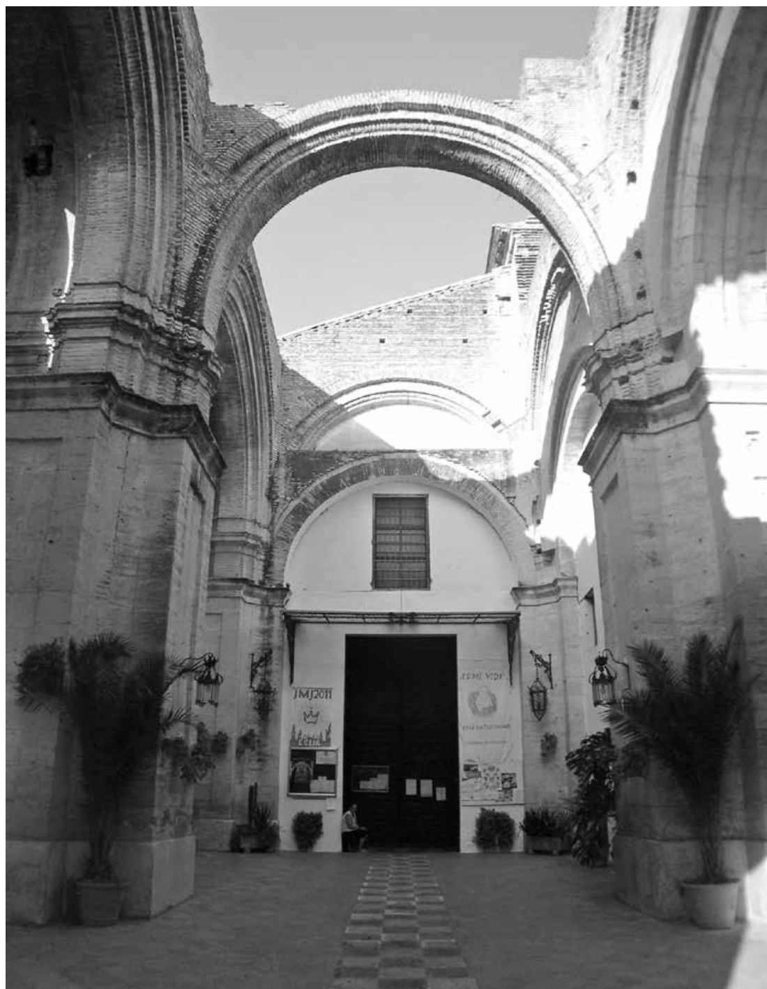
Figura 3. Nave en alberca de la iglesia de Santa Cruz de Écija, que le sirve en la actualidad de atrio de acceso. Se aprecia la estructura original latericia de pilares y arcos, parcialmente recubierta por la fábrica de piedra que dispuso, a partir de 1791, el arquitecto Ignacio Tomás. Proyectado con gran monumentalidad por José Álvarez en marzo de 1776, problemas estructurales y económicos impidieron finalmente la terminación del templo. Fotografía del autor.
