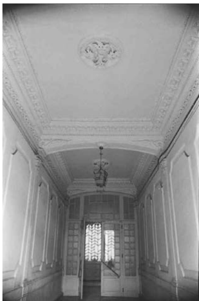
Portal de la casa nº de la calle Don Sancho antes de la última reforma.
