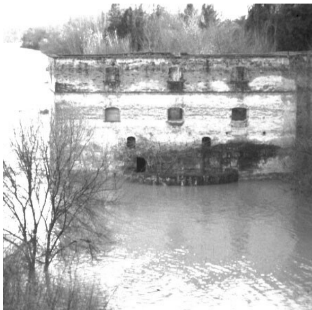
FIGURA 1. El Molino de la Alegría antes de su rehabilitación. (Foto E. Hernández).
