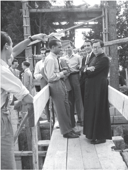
Verano de 1949: Villa Tevere en obras. Frente a san Josemaría, Armando Serrano. Entre ambos, el último al fondo es Fernando Delapiente.
