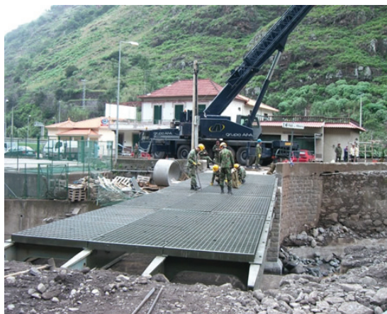
Fot. 6 - Instalação de uma Ponte Militar na Madeira - 2010 (Fonte: Fotografia gentilmente cedida pelo EME).
