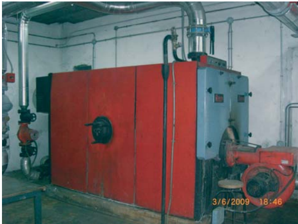
Fotografías de la caldera original, la cual luce bastante deteriorada.
