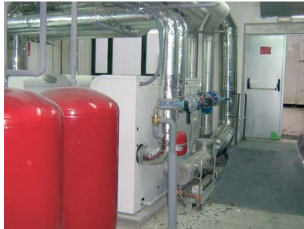
Vista general de la nueva sala de calderas.
