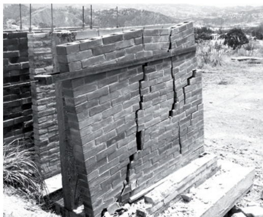
Gráfico 21: Falla ante carga lateral de muro de mampostería estructural con ladrillo industrial
