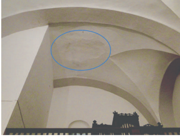
Fig. 2: Iglesia parroquial de Fuente de Cantos. Bóveda del coro con señales de los daños causados por la caída del reloj de la torre
