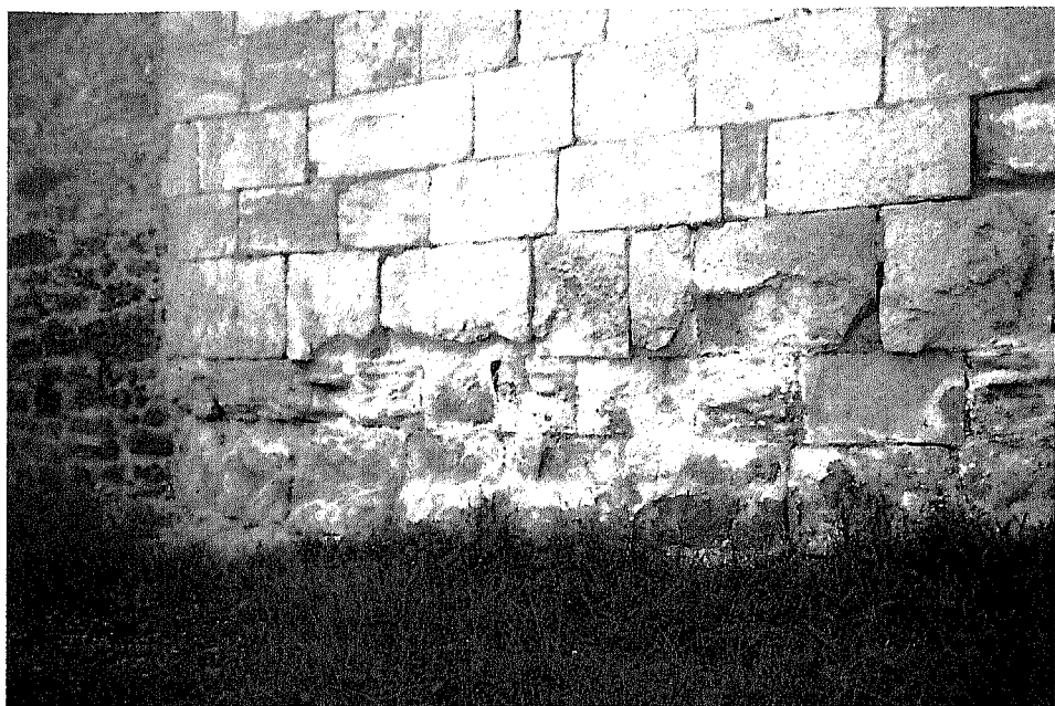
FOTO 5: Fachada principal. La falta del drenaje provoca humedad por capilaridad con el consiguiente deterioro de la piedra.
