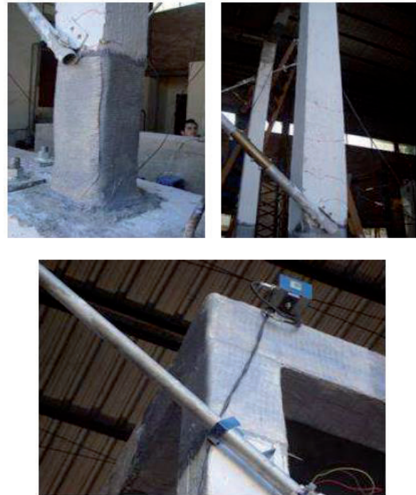
Figura 10. Fisuras en columnas del pórtico con refuerzo, luego de aplicar los 5 inputs dinámicos.
