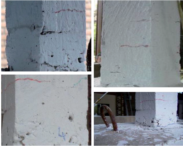
Figura 8. Fisuras en columnas del pórtico sin refuerzo, luego de aplicar los 6 inputs dinámicos.
