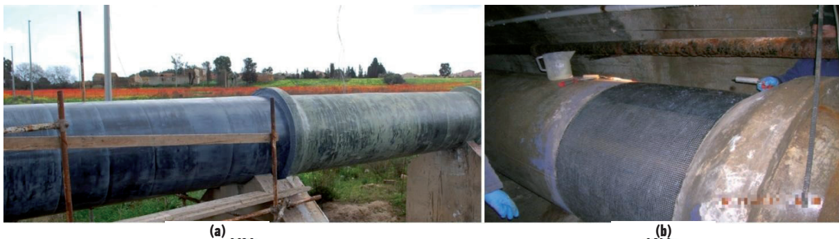
Figure 15. Aplicación de resinas IPN en la rehabilitación y refuerzo de infraestructuras hidráulicas de acueductos de concreto, en combinación con una resina epoxi. (a) Acueducto industrial de concreto del Río Flumentosa – Sardinia (b) Acueductos civiles de Lucania – Sur de Italia – Potenza. (Diseño y tecnología Ing. Gianluca Ussia y Prof. L.A.Credali).
