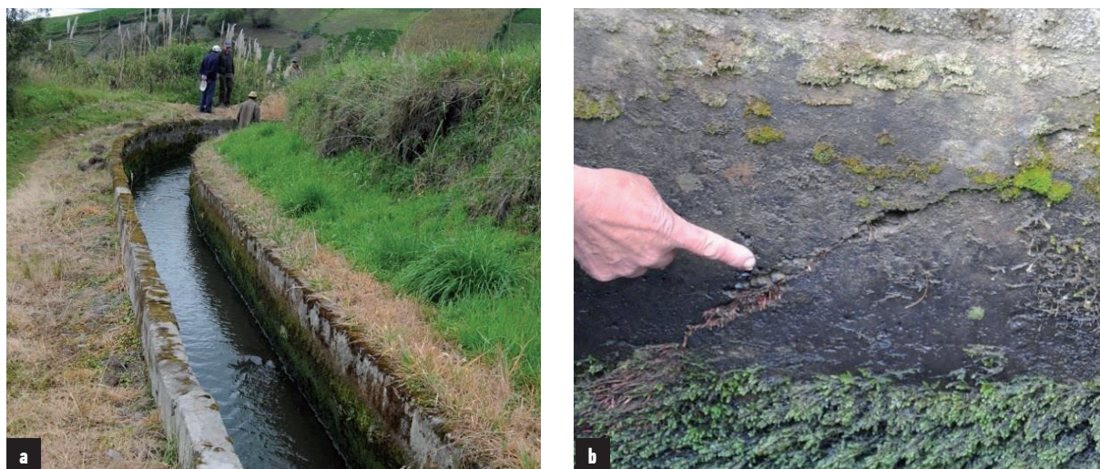
Figura 2. Inspección: a) Aspecto general del canal, b) Detalle de agrietamiento en la pared del canal.
