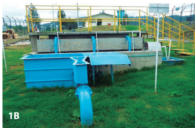
Figura 1. Instalaciones de la PTAR UMNG, Cajicá, Cundinamarca Fuente: Los autores
