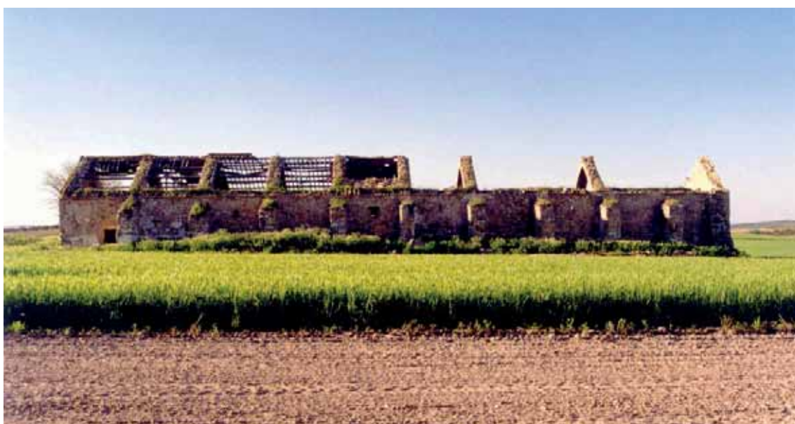
ALZADO SUR DE LA NAVE PRINCIPAL DEL CORTIJO GALLAPE, EL QUE SE MUESTRA A LA ESCUELA
